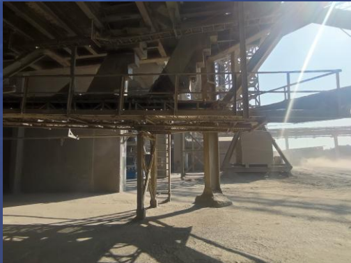
Chute alimentación banda
